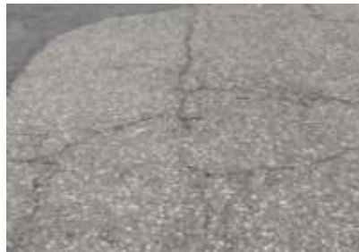
Imagen 7.1.4 Fisura en Bloque de la pista
