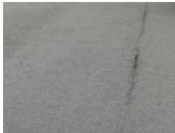
Imagen 7.1.2 Fisura Longitudinal en Junta de Construcción
