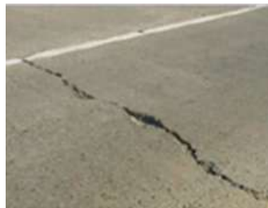
Imagen 7.6.1, falla por estallido
