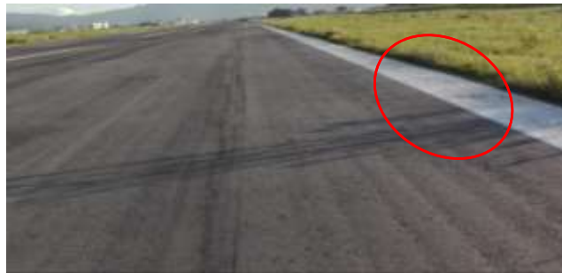
Imagen 7.1.3 Fisura de Borde de una pista
