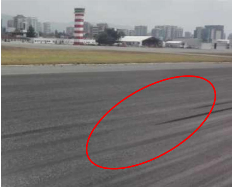
Imagen 7.2.4 Ahuellamiento en una pista
