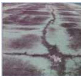
Imagen 7.6.6.1 falla por bombeo
