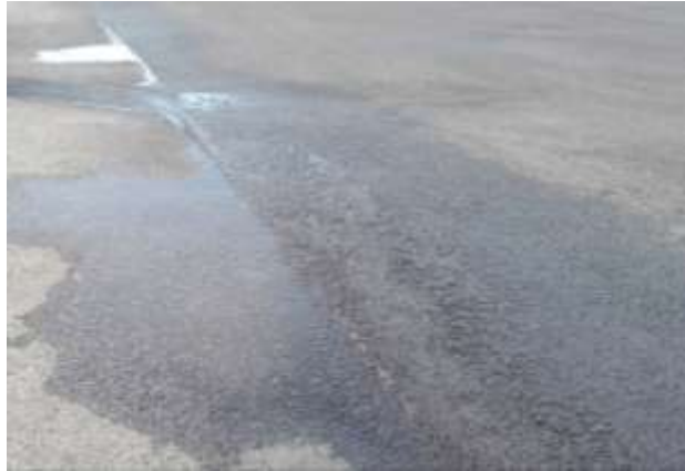
Imagen 7.2.3 Hundimiento en una pista
