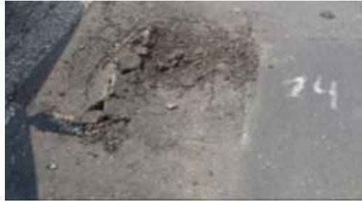
Imagen 7.3.1 Descascaramiento en pistas de aterrizaje
