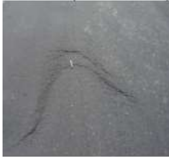
Imagen 7.1.6 Fisuración por deslizamiento
